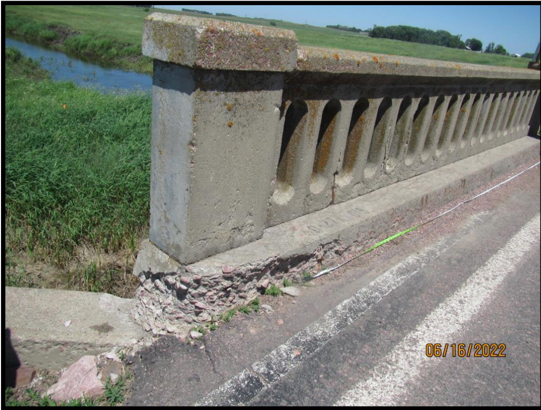
50-277-015_2022_11_CDI_NW Concrete Curb Spall
